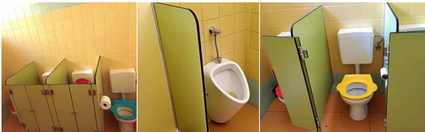
Děti si mohou vybrat, zda použijí toaletu v kabince nebo s přepážkou. Kluci mají radost z pisoáru. A dvířka u toalet se dají plně otevřít a pohodlně zde uklidit
